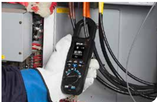
Měření hodnot proudu
