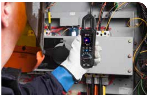
Scan rozvaděče s technologií IGM
