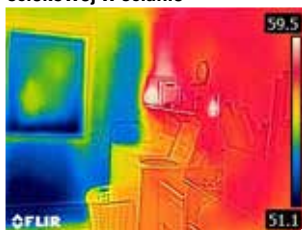
Nieizolowana ściana nośna
